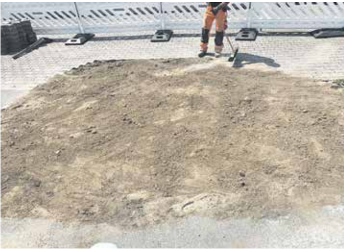
Aus der Delle war ein Loch geworden, das mittlerweile verfüllt ist. Foto: Stadt Riedstadt
