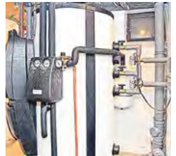
Im Tank lagert der Brennstoff für eine moderne und effiziente Öl-Brennwertheizung. Es handelt sich dabei um eine Mischung aus klassischem Heizöl und einem erneuerbaren Energieträger. Foto: IWO/trd/akz-o
