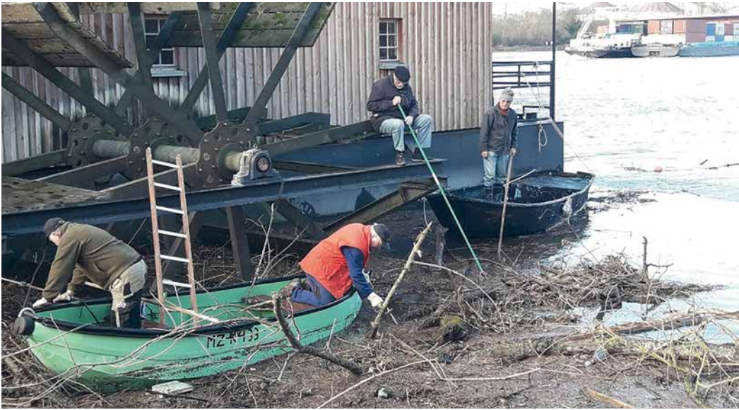
Aufräumen nach dem Hochwasser.
